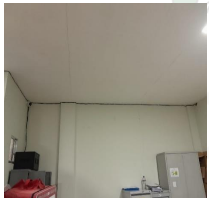
Foto 02 – Detalhes de rachadura no gesso do teto no CAF Data 12/09/2023
