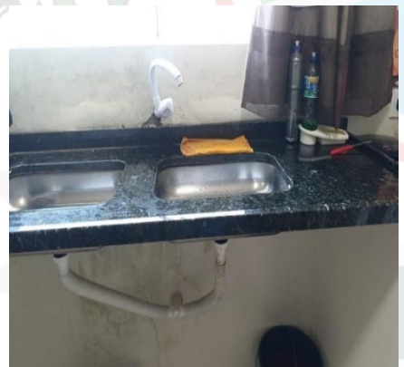
Foto 03 – Detalhes de vazamento na pia de higienização no CAF Data 12/09/2023
