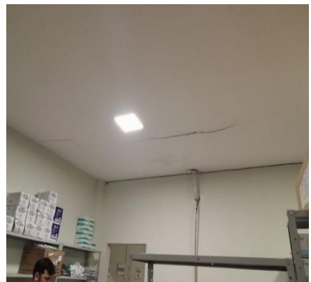
Foto 01 – Detalhes de rachadura e infiltração no gesso do teto no Cômodo de armazenamento dos descartáveis no CAF - Data 12/09/2023
